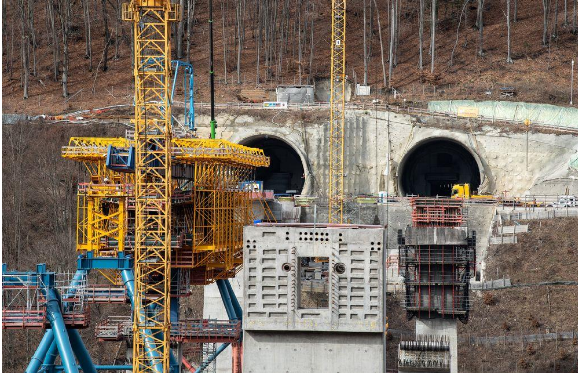
Aufwändige Bauarbeiten: Rund um Stuttgart werden die Fernverkehrsstrecken unter die Erde gelegt.
