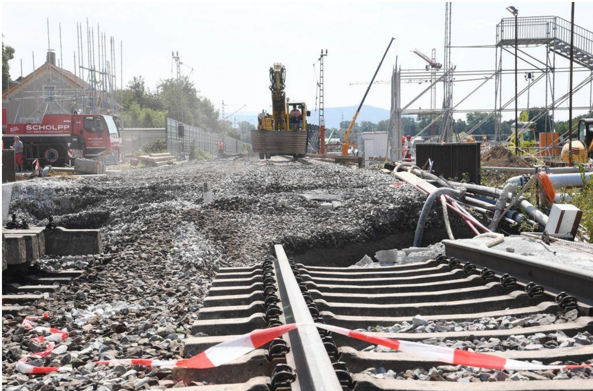
Tunnelhavarie bei Rastatt: Die Gleise über dem Tunnel senkten sich ab, die Röhre musste teilweise mit Beton befüllt werden.
